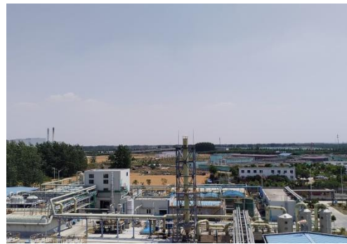
污水处理装置
